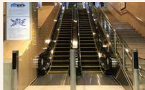
博多駅筑紫口エスカレーター Chikushi Entrance escalator in Hakata Station
