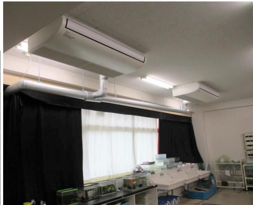
福岡市 PPP/PFI事業ホームページ 小中学校特別教室空調整備事業より 抜粋
