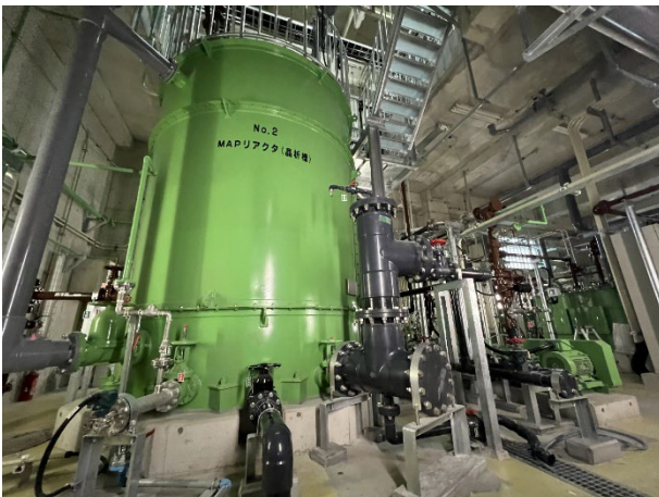
リン除去回収設備
