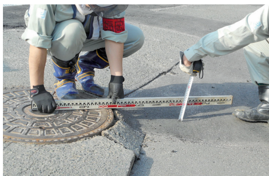
【マンホール浮き上がりの確認（熊本市）】
