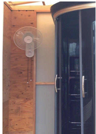
【仮設シャワー】
