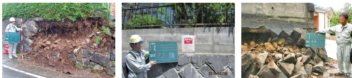
【宅地の危険度判定状況】
