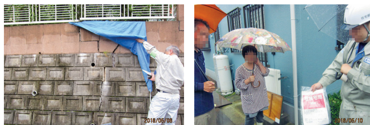
【宅地の危険度判定状況】
