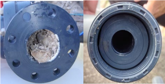
図 6. 通常 PAC (左) と高塩基度 PAC (右) の配管詰り
