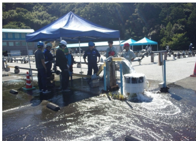
夾雑物排除のための立上洗管
