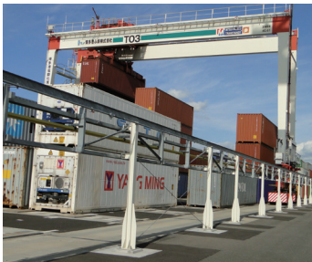
■トランスファークレーンの電動化 RTG Electrification
