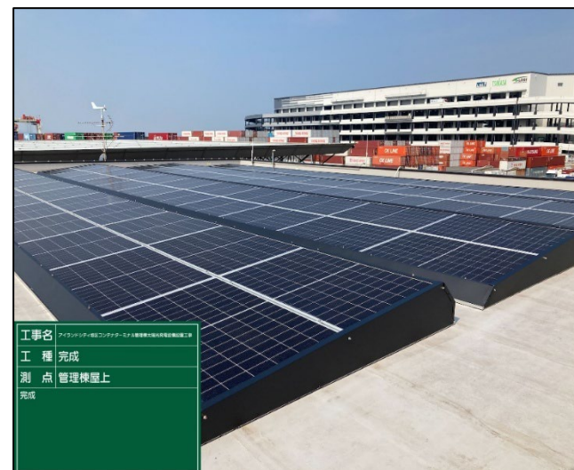
《太陽光発電設備》
