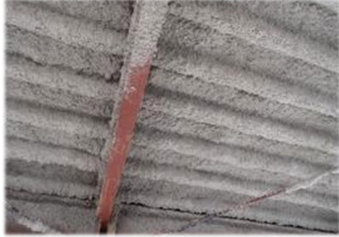
吹付け石綿（レベル1）
