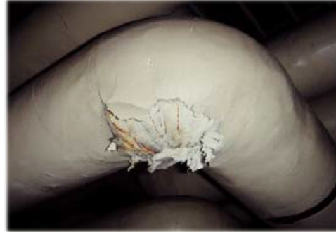
石綿含有保温材（レベル2）
