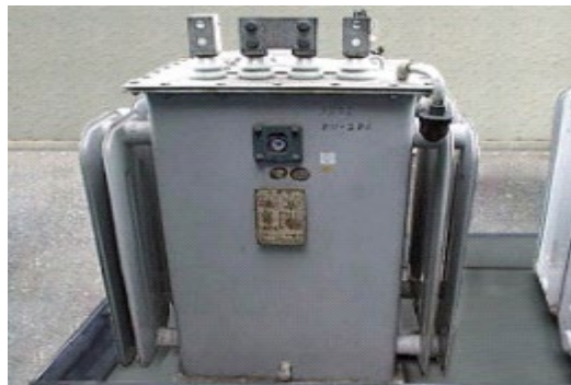
変圧器（トランス）
