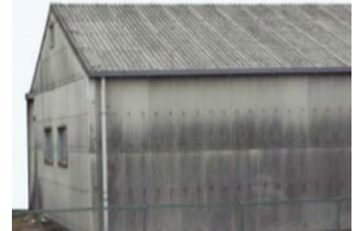
石綿含有波板スレート（レベル3）
