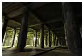
雨水流出抑制施設の整備 (山王2号雨水調整池)
