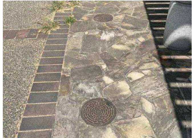
マンホールトイレ（大浜公園）
