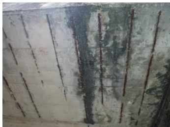
劣化状況（剥離発生）
