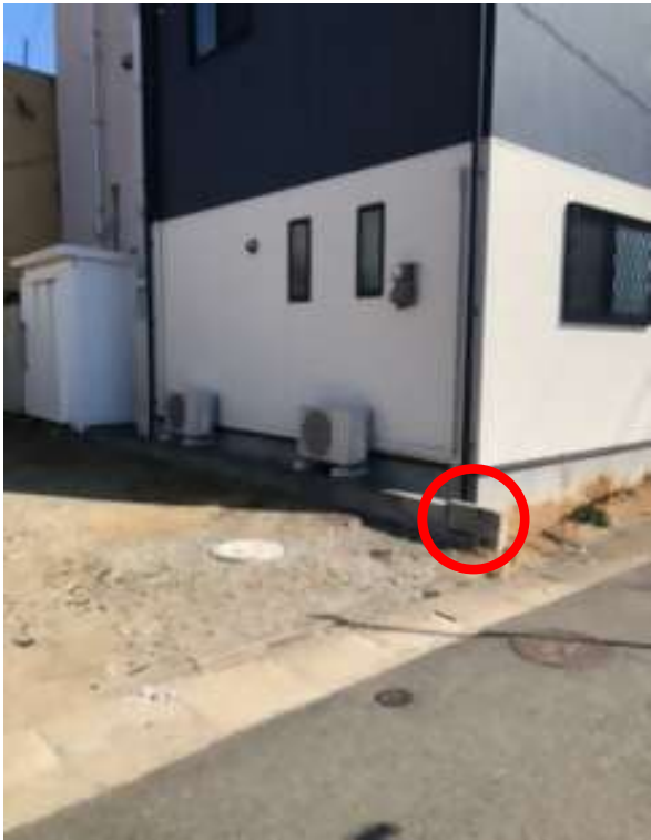
事故現場写真
