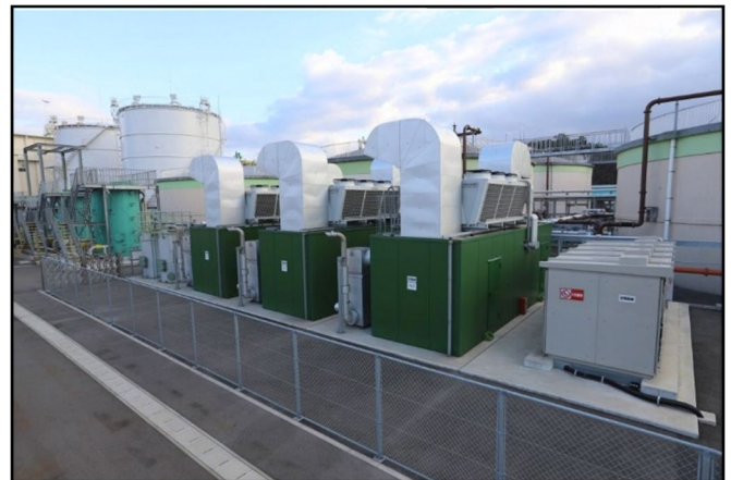
下水バイオガス発電
