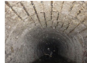
直ちに改築が必要と判定された事例
