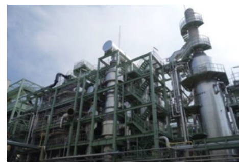
高温焼却システム
