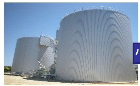
汚泥消化タンク
