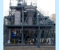
リン回収施設(横浜市)
