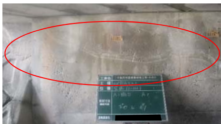
①【橋台のひび割れ】
