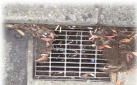
排水ますの詰まり
