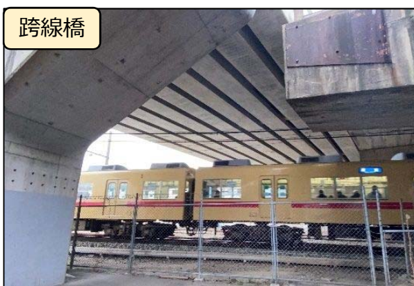
コンクリートが落ちると車や鉄道車両に当たる恐れがあります
