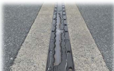
橋の継ぎ目の異常
